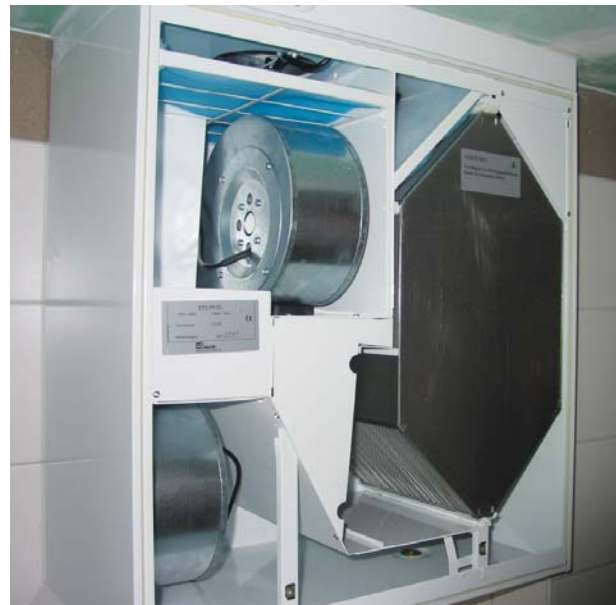
Obr. 6 O kvalitní vnitřní prostředí a neustálý přísun čerstvého vzduchu se stará větrací jednotka. Díky vysoce účinnému rekuperačnímu výměníku je vzduch ohříván na teplotu blízkou pokojové i v nejteplejších mrazech. Dohřát je pak potřeba jen zbylých pár stupňů.
